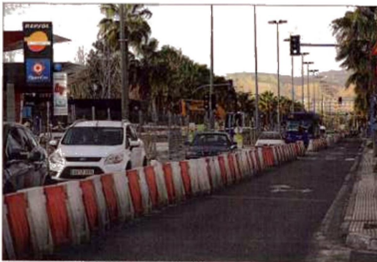
Obras que se están acometiendo en la avenida de Novelda. PLAN CONTRÓ.
